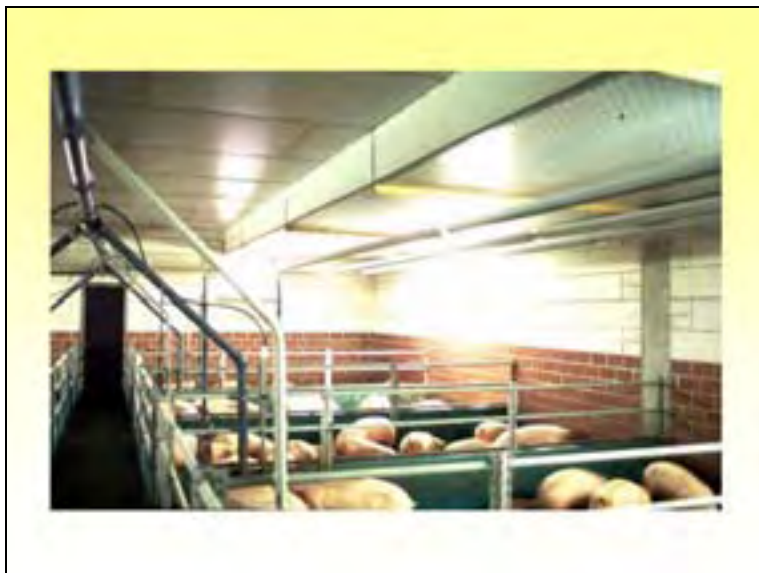
Bild 7: Die Frischluft tritt bei Einhaltung der Planungsdaten gleichmäßig aus dem perforierten Kanalboden aus
