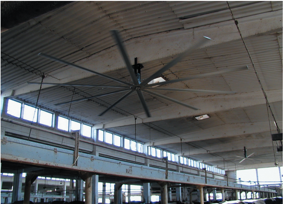
Abbildung 7: Deckenventilatoren (sog. Big Fans) in einer Großanlage in Sachsen
